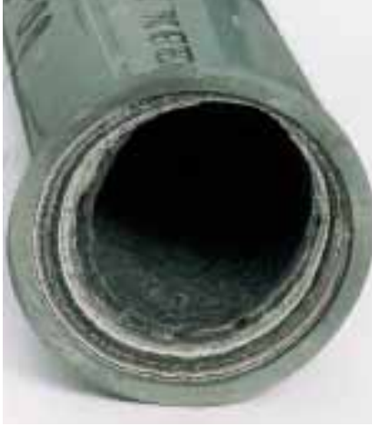
PVC-leiding van betonproductie. De dikke kalkafzettingen zijn duidelijk zichtbaar.
